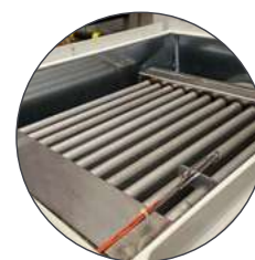
Intercambiador de calor
