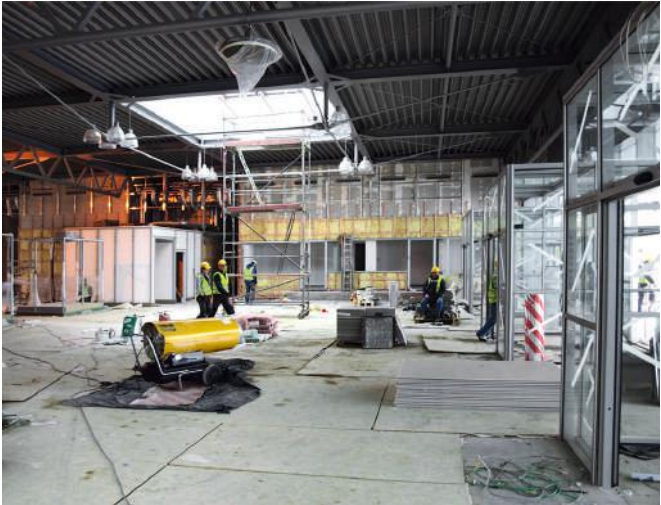
Calefacción en obras (Master B 180)
